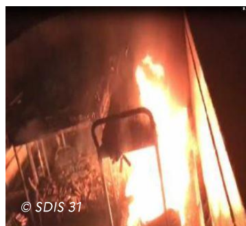
ARIA 54538 – Incendie à la suite d'un emballement thermique d'un élément et propagation aux autres batteries.
